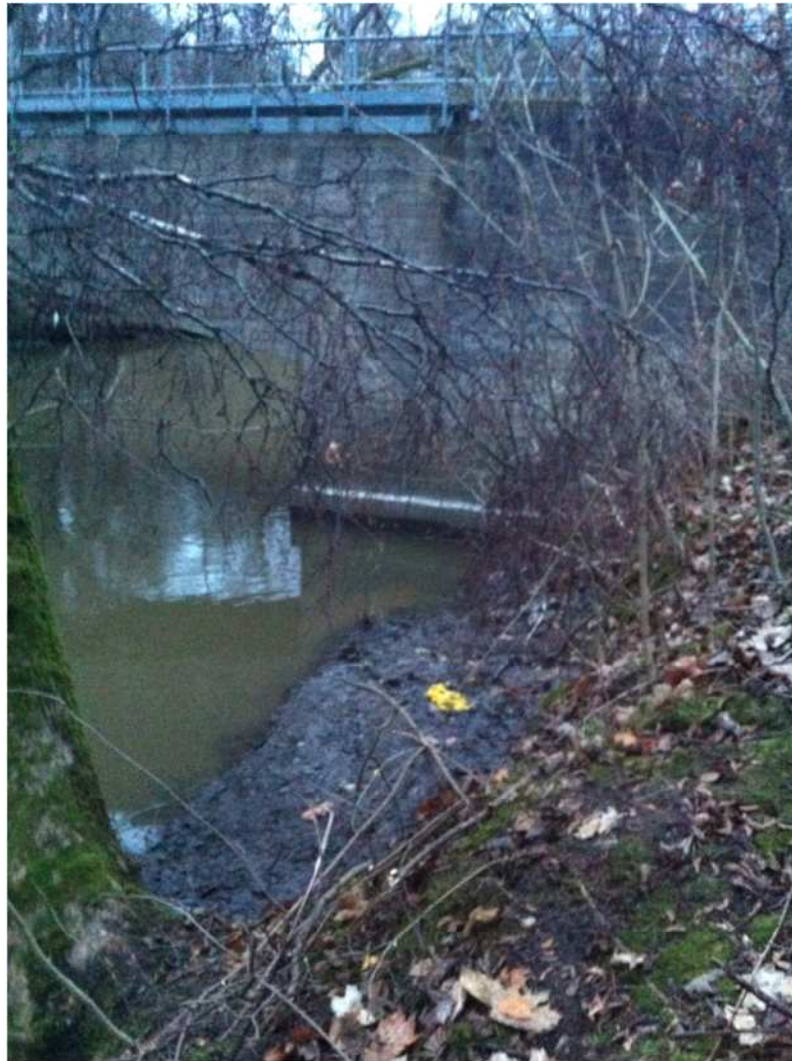
Figur 3 Erosion längs Lärjeån, ledningsbron
