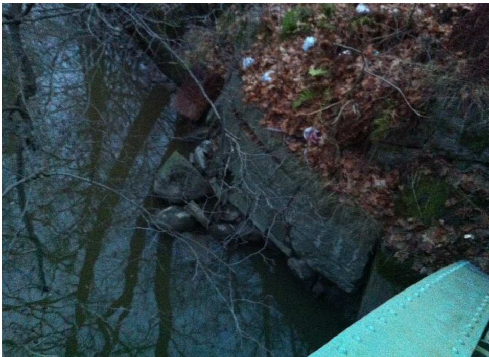
Figur 4 Erosion längs Lärjeån, västra bron
